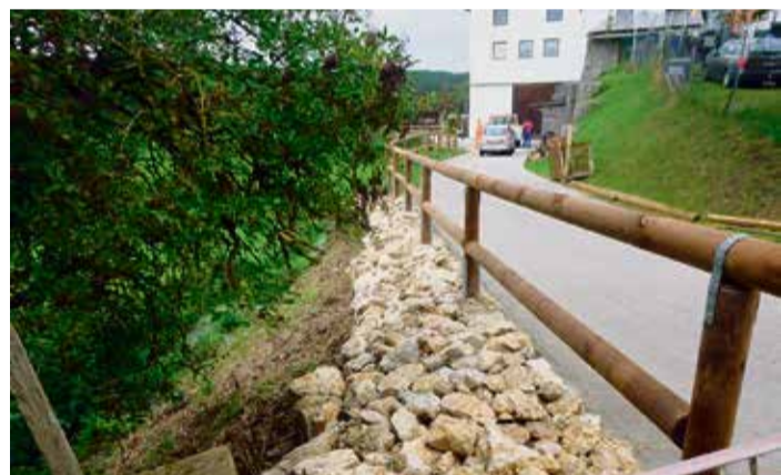
Das neue Holzgeländer in Bernlohe wurde ein Stück nach oben gesetzt und verhindert das Abrutschen des Hanges.
